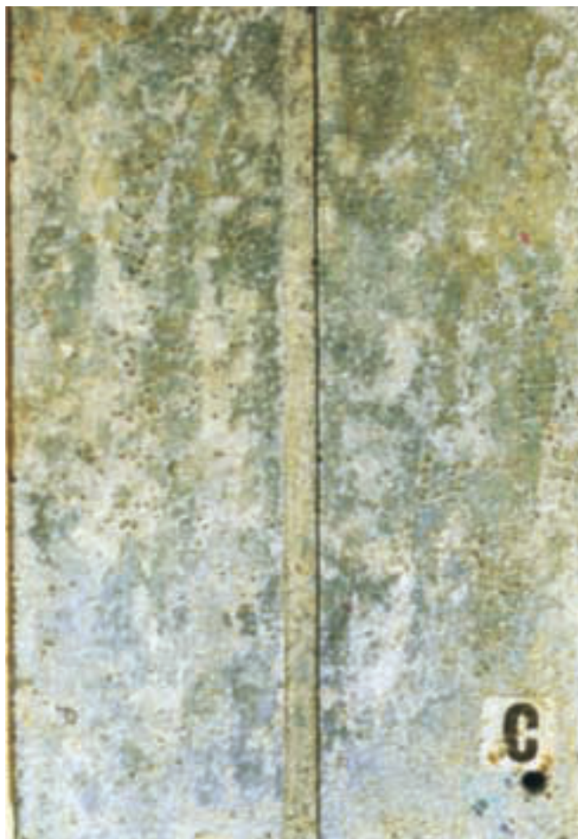
Et 6 mm bredt fræset spor gennem en 60 µm tyk zinkbelægning på stål og eksponeret i 5 år i svært industrimiljø i Holland. Bemærk belægningen af zinksalte i sporet der er uden rustangreb. (Foto: J F H van Eijnsbergen).
