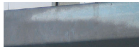
Färgskiftningar i ytan kan förekomma, men påverkar inte kvaliteten på korrosionsskyddet. Anledningen är att reaktionen mellan zink och järn går olika fort beroende på typ av stål samt svalningsförloppet efter förzinkningen.
